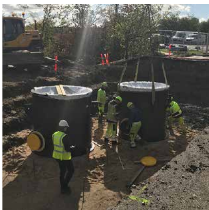
Denne løsning bestående af Böhmer DN500 full bore kugleventiler indbygget i præfabri- keret ventilbrønd med Rotork IQT elektrisk styring, kørebanedæksel samt eksternt kon- trollskab til betjening af ventilbrøndene.
