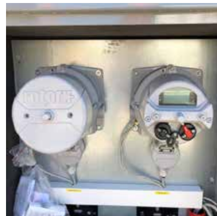
Lokal styreskab med 2 stk. fjernbetjente hand on station, hårdt fortrådet løsning.
