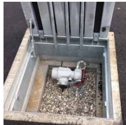
Åbent dæksel med Rotork-aktuator monteret på Böhmer-ventiler i betonstøbt brønd.
