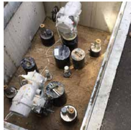
Ventilbrønd med Böhmer double block and bleed ventiler med Rotork aktuator og afsluttet med et fjederdæmpet svejst dæksel for let åbning af brønden.
